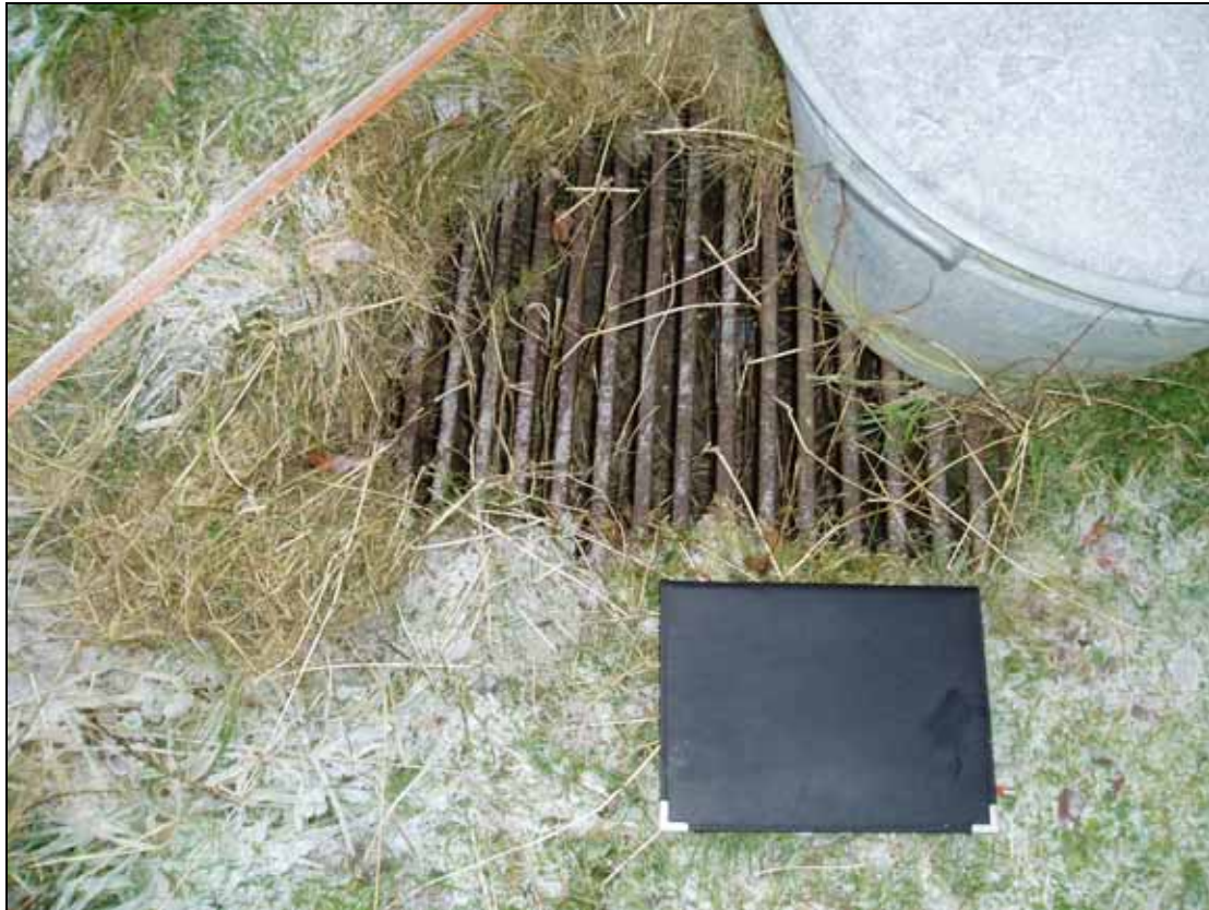
Foto 3: Schacht zur Oberflächenentwässerung
